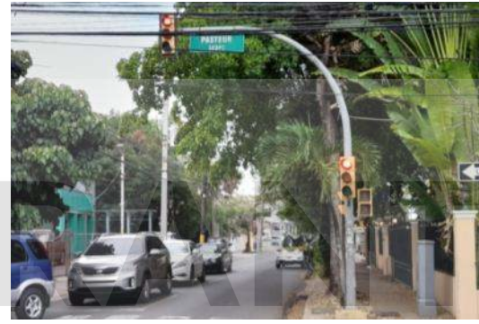
Semáforo peatonal fuera de servicio
