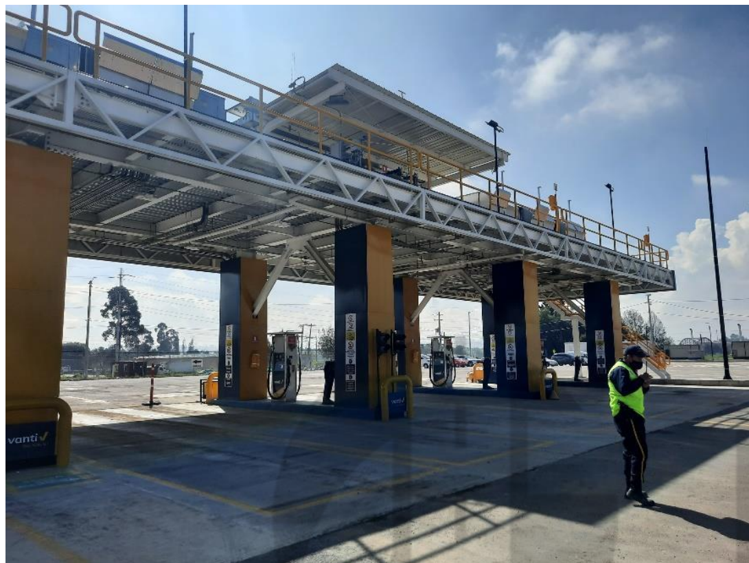
Abastecimiento – estación Gas
